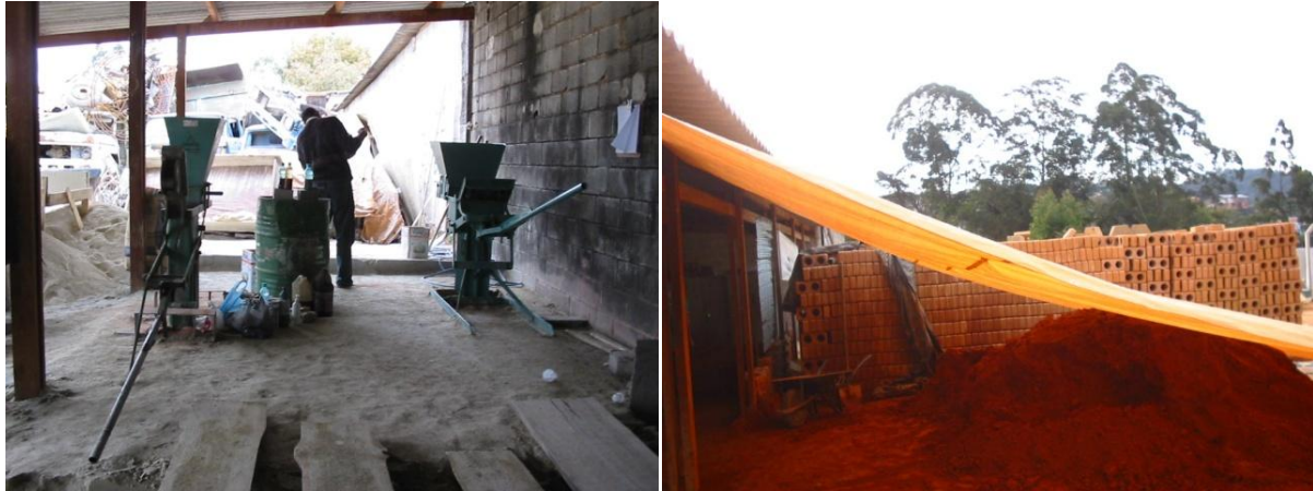
Figuras 7 e 8. A fábrica de tijolos na sua fase inicial de organização. Fonte das imagens: arquivo Pró-Habituação.
