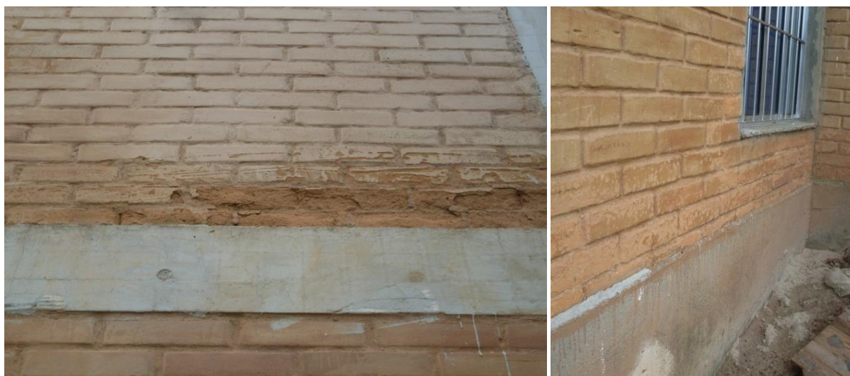
Figuras 28 e 29. Paredes onde os tijolos de solo-cimento, do primeiro lote fabricado, com solo do município, estão “esfarelando”. Fonte das imagens: arquivo Pró-Habituação.
