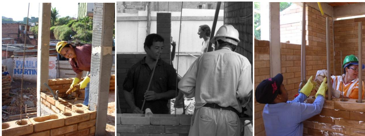
Figuras 19, 20, e 21. Diversos momentos do trabalho em mutirão, no Valo Verde, com a alvenaria de solo-cimento: assentamento de blocos com argamassa, com cola branca, execução de instalações hidráulicas embutidas, grautes. Fonte das imagens: arquivo Pró-Habitação.
