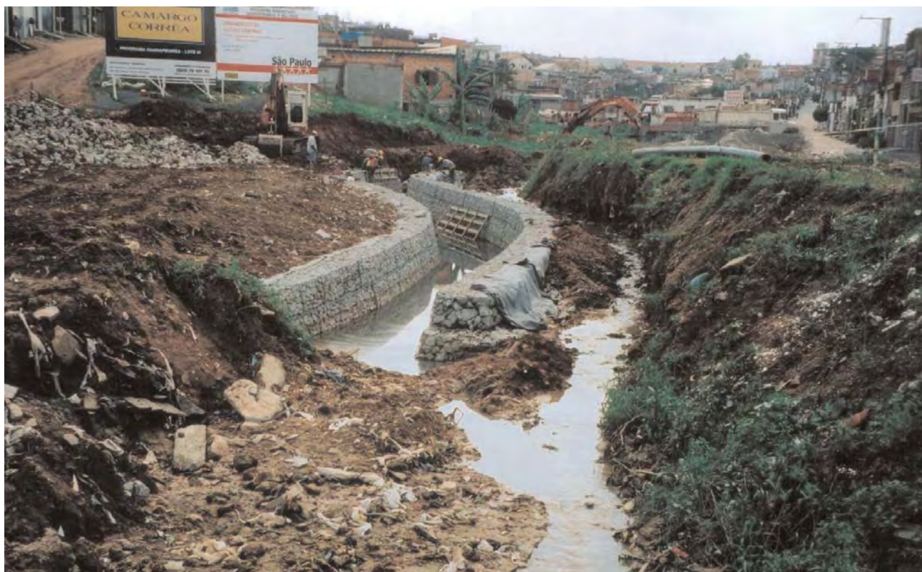
Obras de urbanização na favela Santa Fé - nova esperança para os moradores
